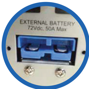
Entrada banco de baterías externas
