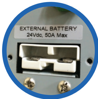
Entrada banco de baterías externas
